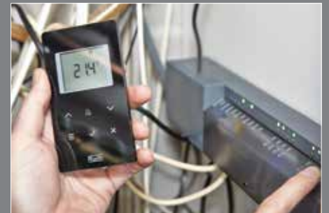
VVS-installatøren tilmelder alle Roth Touchline rumtermostaterne med få tryk.
